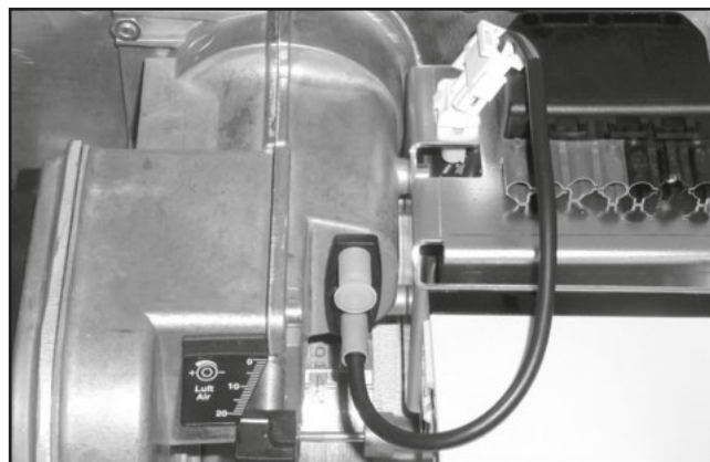
Figure 29 — Prise de raccordement de la cellule photo-électrique
